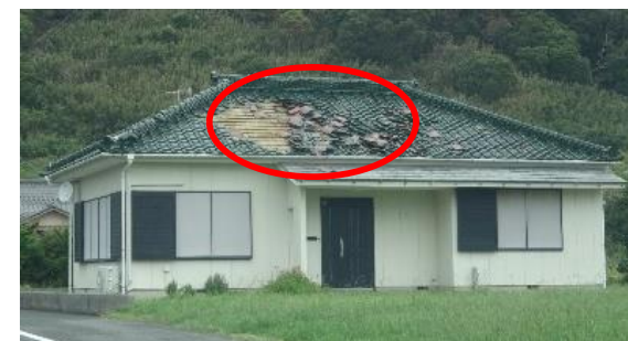
強風による屋根の被害(南房総市)
